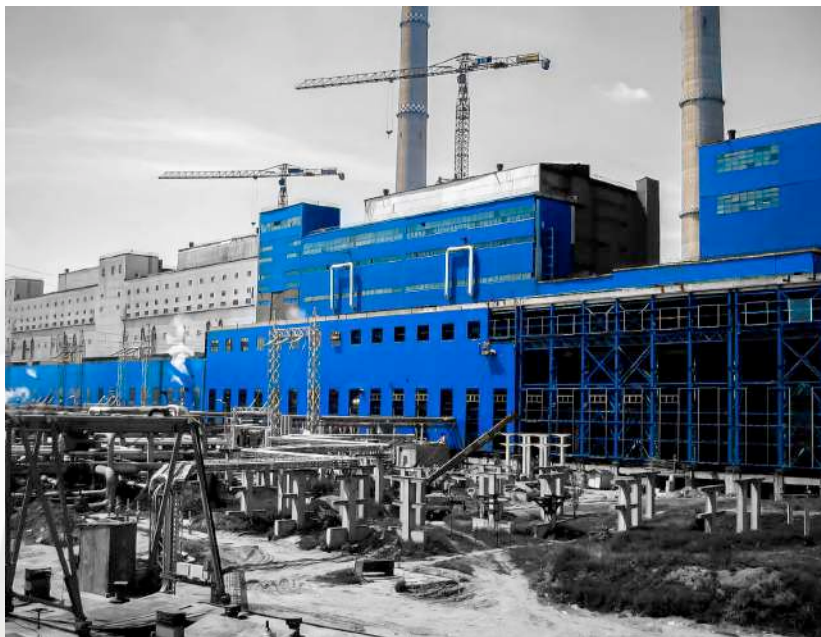
CENTRALA ELECTRICĂ, DROBETA-TURNU SEVERIN
